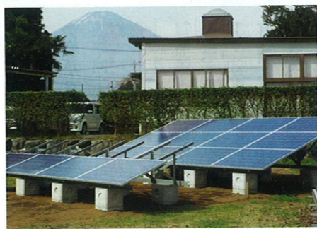
陸屋根への太陽光発電モジュールの設置。屋根強度や建物全体に与える影響を考慮しながら、発電効率のよい角度で架台を設置していく
